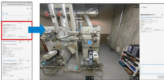
画面1：「空間データ作成・利活用AIソリューション」ビューア上で設備の詳細を表示している画面（出典：BIPROGY）
